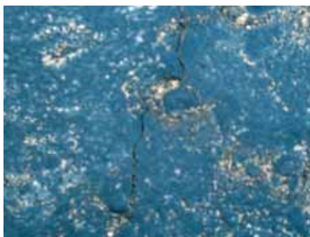
Trhliny v stabilizovaném cementu
